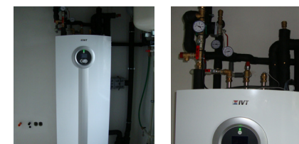
Tepelné čerpadlo využívající teplo z plochy zahrady
